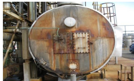
Incinerator（焚化炉）涂层前 185℃
